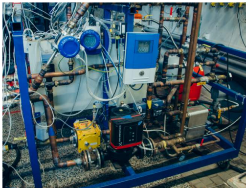
Chladičí smyčka s uzavřeným okruhem odděleným deskovým výměníkem. Zdroj: SZU
