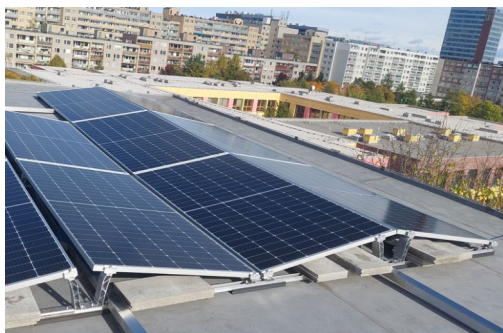
Příklad konstrukce typu východ-západ, kde není dostatečný odstup mezi PV moduly a jsou zde zhoršené podmínky pro servis. zdroj: UCEEB
