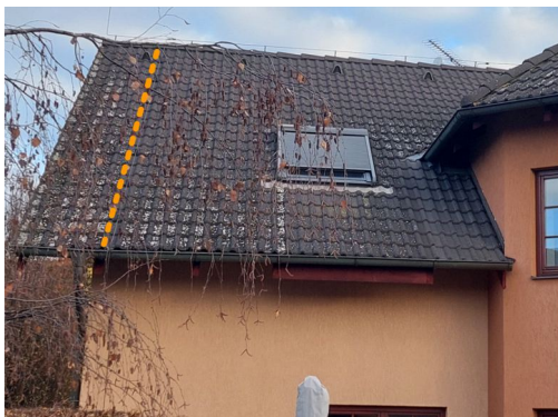
Příklad rodinného domu, kde je nezbytné nahradit část stávajícího svodu vodičem HVI, aby bylo možné střechu využít pro instalaci PV modulů zdroj: UCEEB
